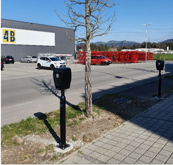
Abb. 3: 2 Doppelladestation-Säulen für die Elektromobilität
